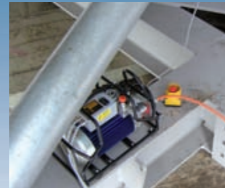
Bei der Blattmontage: Eine Plarad-VAX 2 Z steht unter der Nabe und versorgt den Spannzylinder mit dem nötigen Betriebsdruck.
